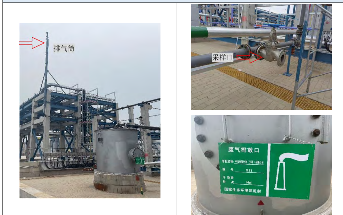
7、P 10-1 危废间废气排放口 1#和 P 10-2 危废间废气排放口 2#
