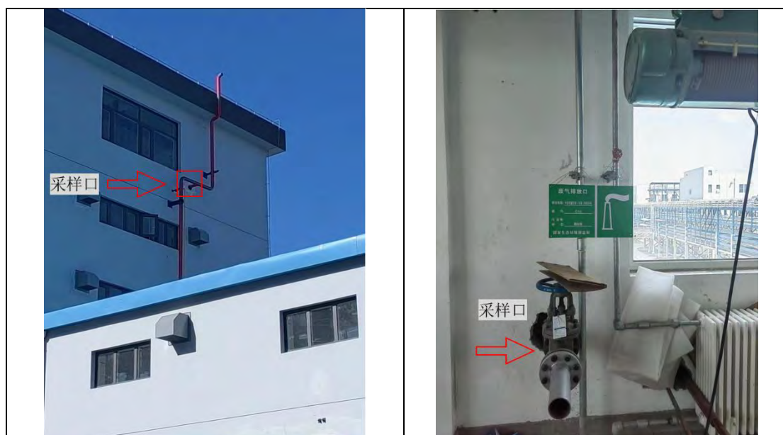
6、P 11 罐区废气排放口（采样口、标识、标识牌）
